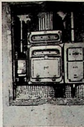
Verdeelpunt in nis met achterwand van steengaan.
